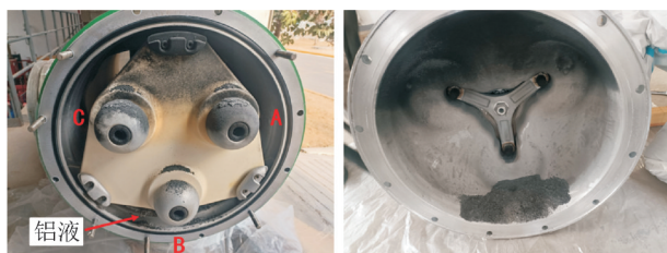
图9 快速接地开关操动机构侧端盖内部情况
